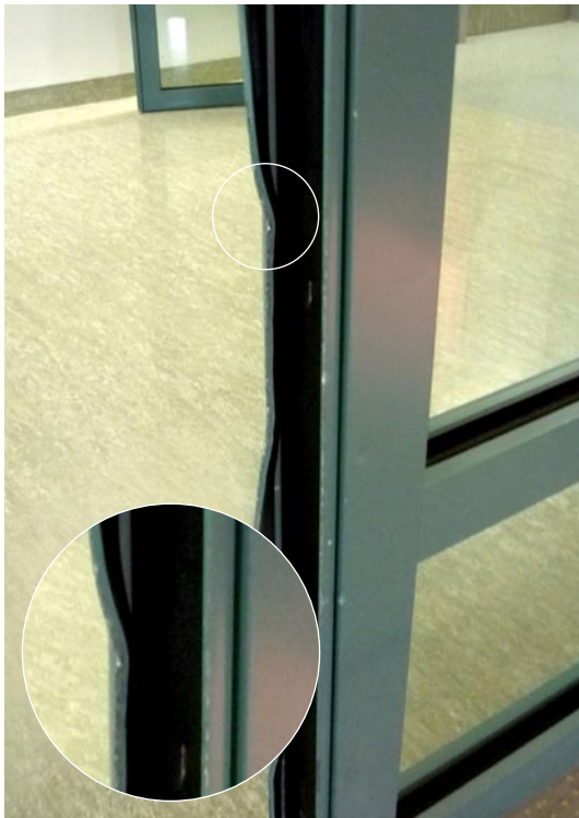
Typische Tür-Beschädigung durch Bettentransport in einer Pflegeeinrichtung
